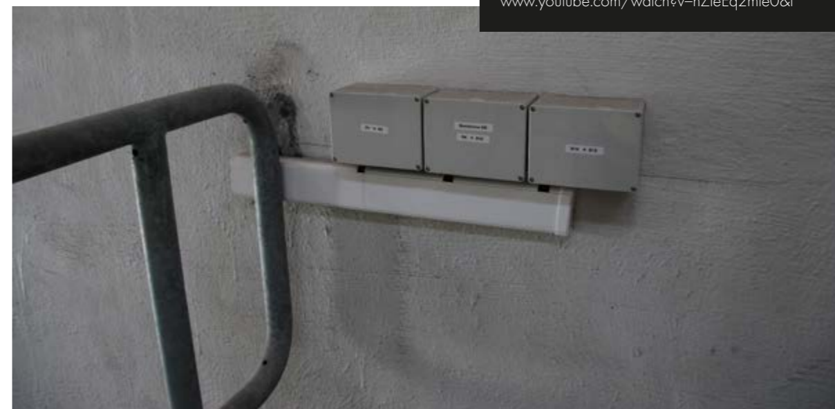
Monitoring Kathodische Bescherming
