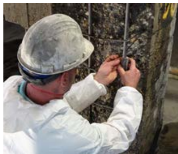
Monitoring de la protection cathodique avec anodes sacrificielles - Ecluse Pierre Vandamme à Zeebrugge
