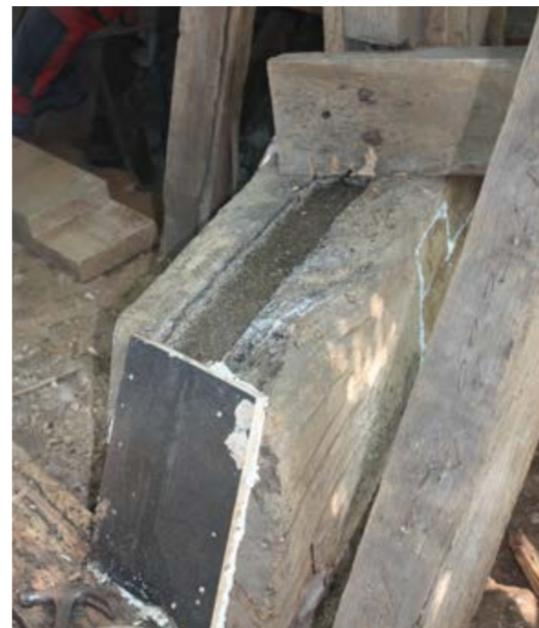
Certains dégâts sont apparents en surface, d'autres touchent le cœur des poutres
